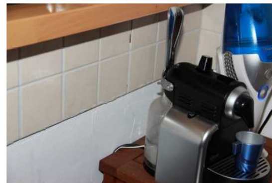
Figure 34 A2dr-barde la cuisine, fissure côté cuisine
